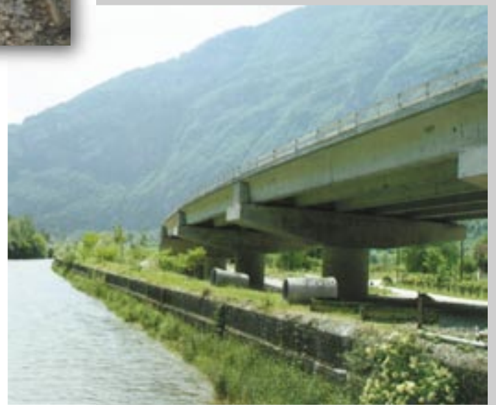
Gabioni postavljeni kao zaštita od erozije u blizini vijadukta na auto cesti
