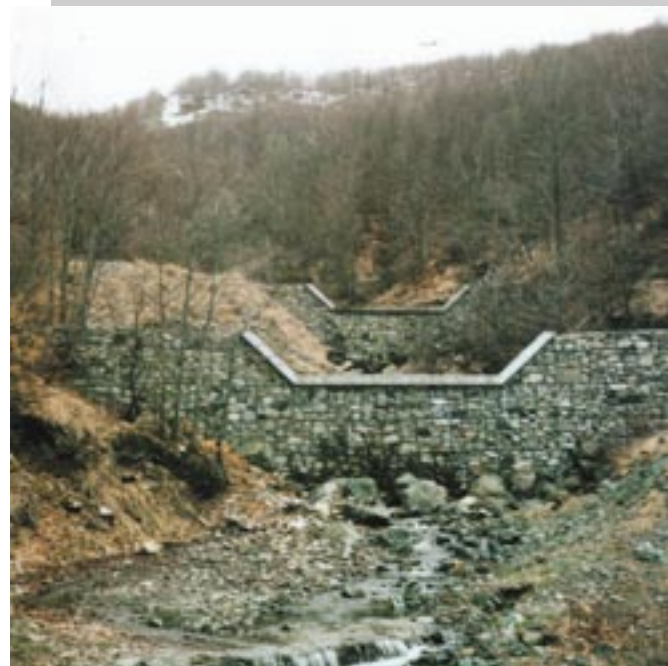
Primjer postavljanja brana. Obratite pozornost na pokrov u armiranom betonu koji štiti pletivo naprikazanom dijelu
